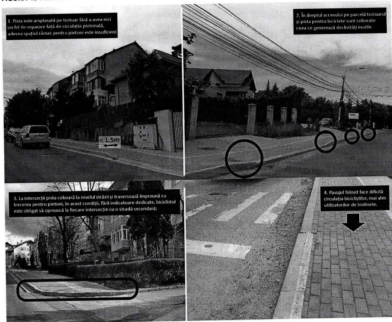
FIGURA 48 PROBLEME IDENTIFICATE ÎN PROIECTAREA ȘI EXECUȚIA PISTELOR PENTRU BICICLETE
